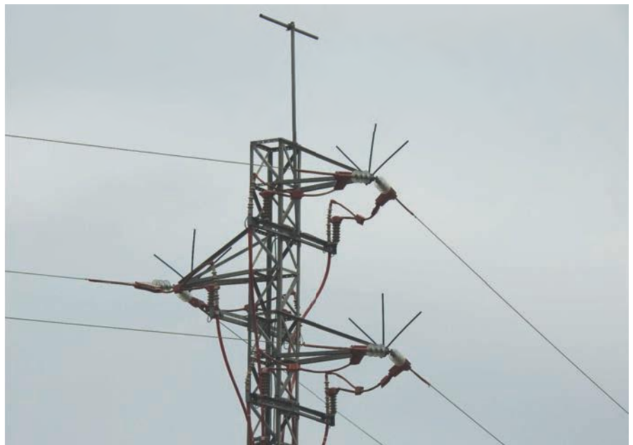
Abb. 3: Gesicherter Mittelspannungsmast bei der Deponie Montoliu de Lleida.
